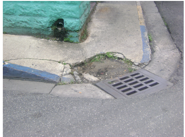
5. Acceso para impedidos deteriorado
