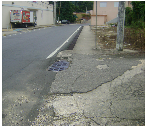
2. Paso peatonal deteriorado
