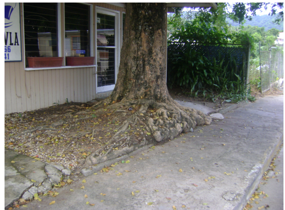
4. Raíces afectando acera
