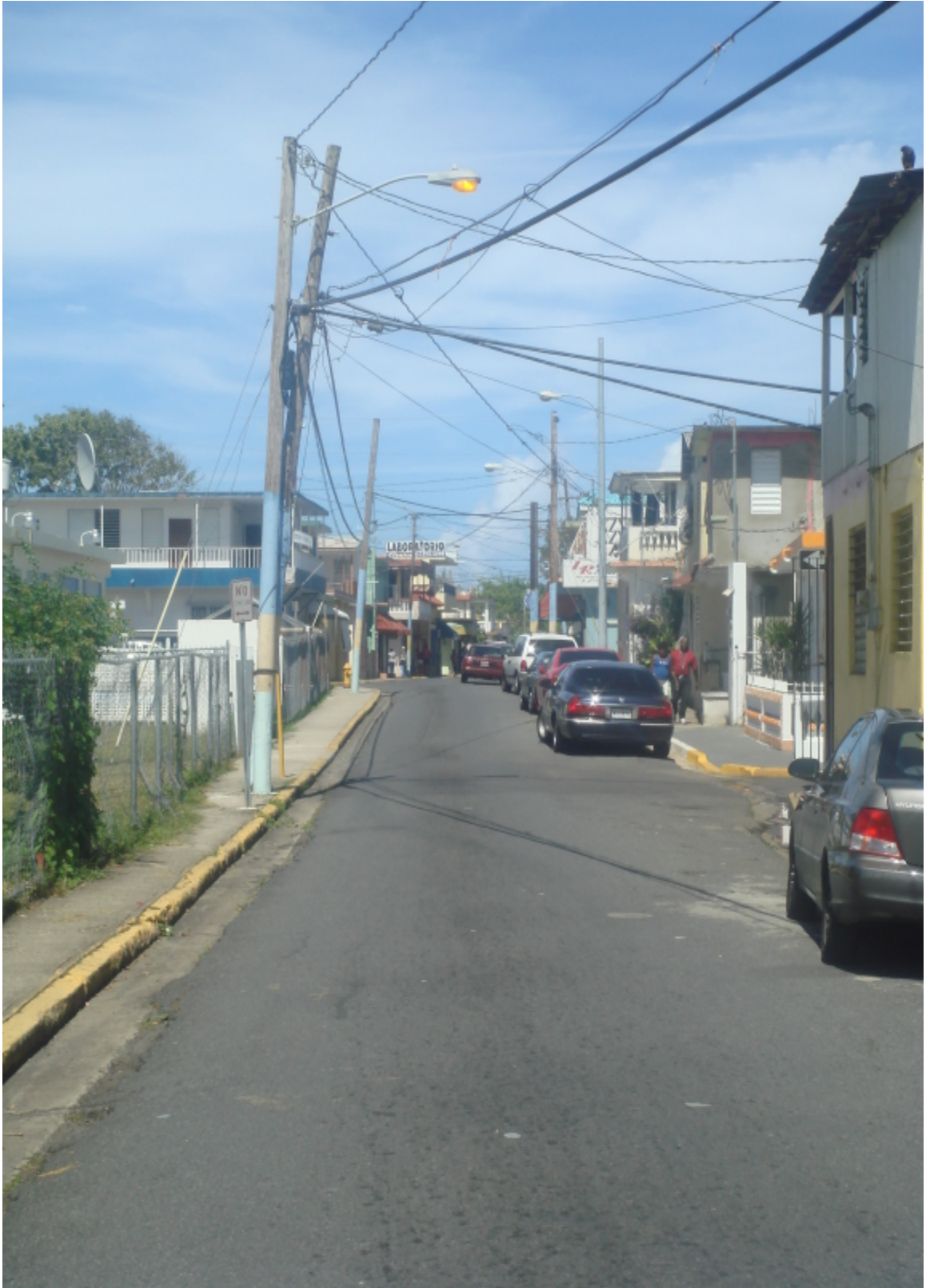
Apéndice 15: Foto del Sistema de Cableado Eléctrico.
