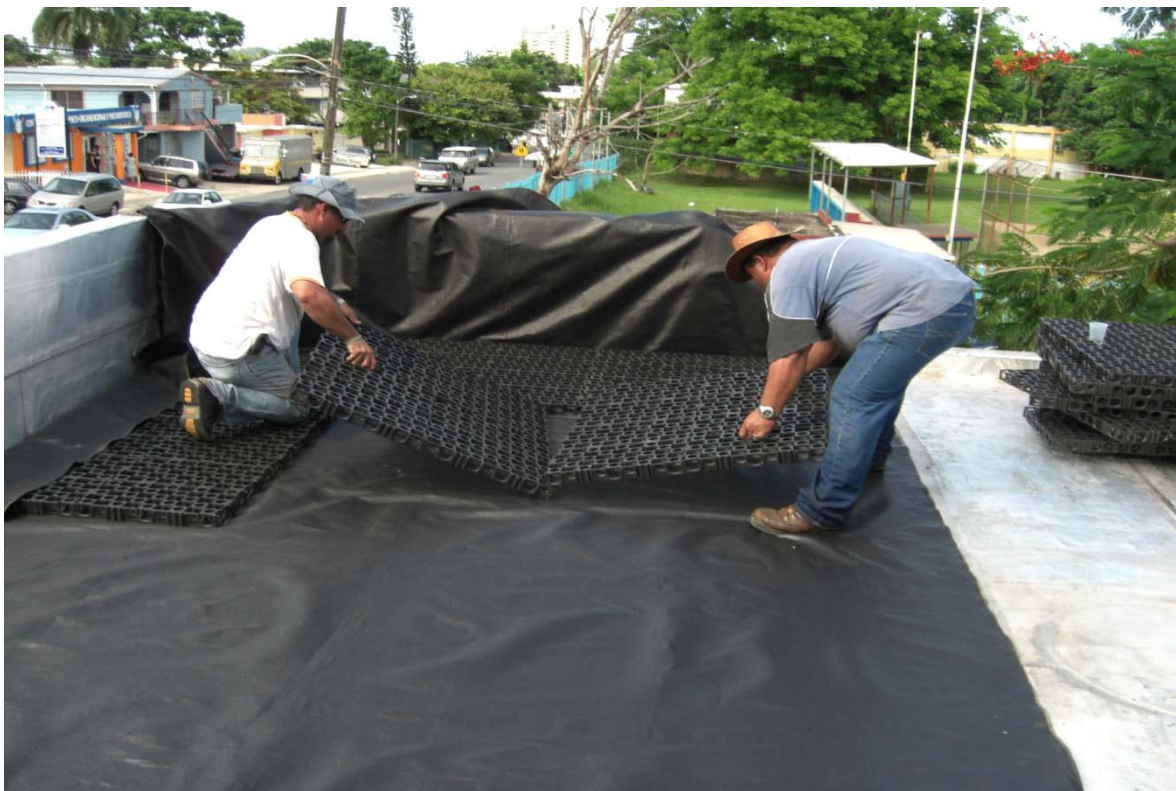
Instalación de las celdas de drenaje Atlantic Drainage Cells sobre la superficie del techo.
