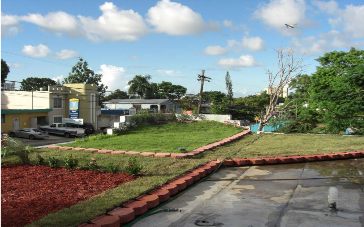
Finalización en la instalación de la segunda fase del sistema con cubierta vegetal.
