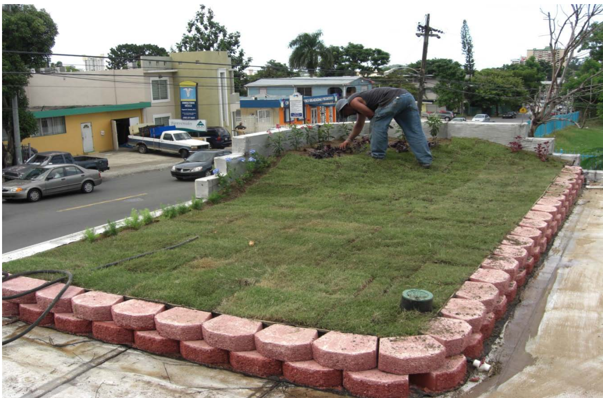
Finalización de la instalación de la primera fase del sistema con cubierta vegetal.
