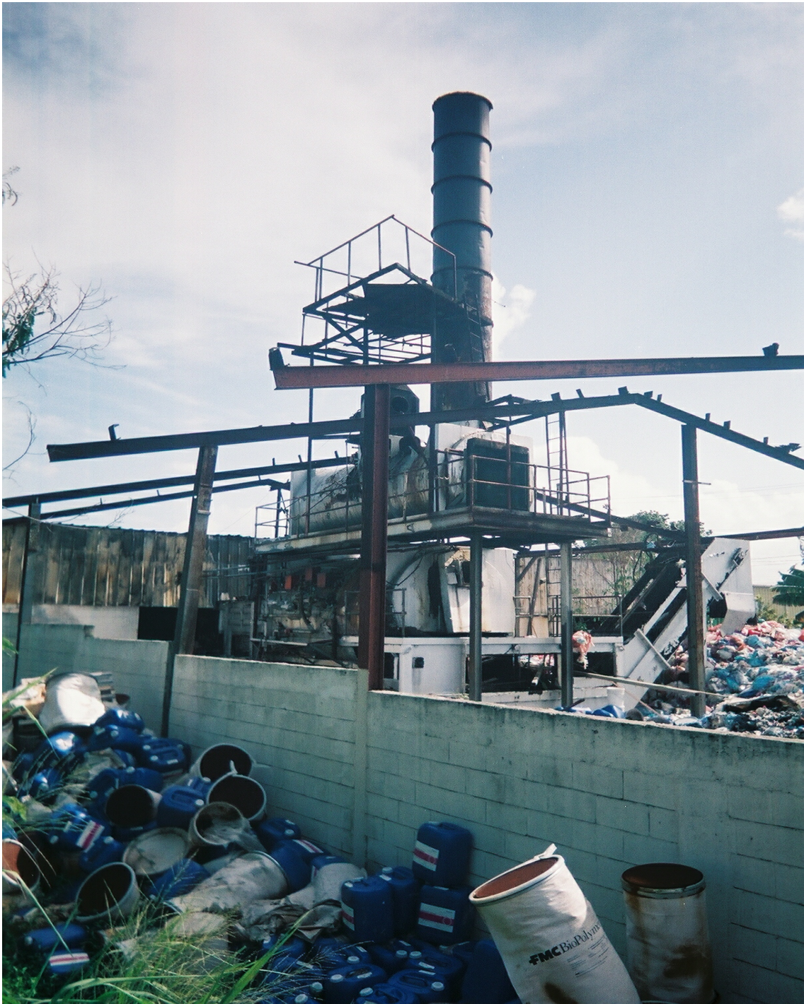
Figura 5. Vista del antiguo incinerador de DBR de Biocelsius tras de sufrir un incendio que destruyó parcialmente las instalaciones reduciéndolo a herrumbres. Nótese la acumulación de DBR aún en el área cercana al incinerador y la gran acumulación de contenedores de sustancias químicas vacíos en el lado izquierdo de las instalaciones. Tomada el día 29 de septiembre de 2007.
