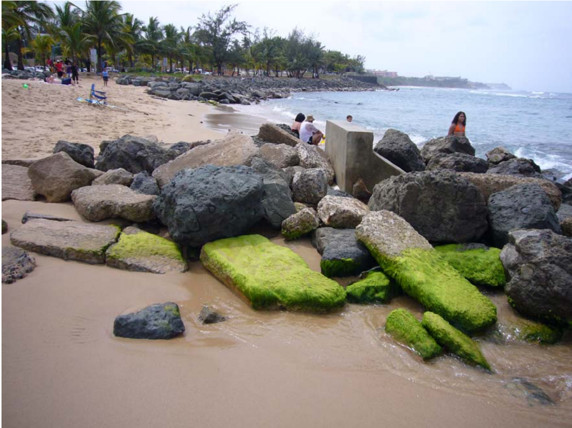
Apéndice 1. Desagüe del alcantarillado Pluvial en la playa de Escambrón
