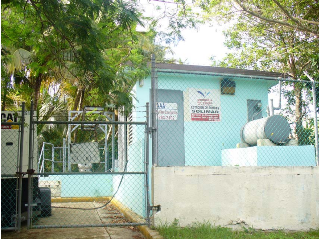
Apéndice 5. Estación de Bombas Solimar
