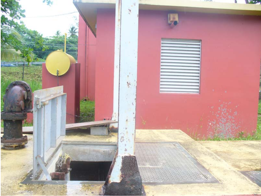
Apéndice 7. Estación de Bombas del Balneario La Monserrate.
