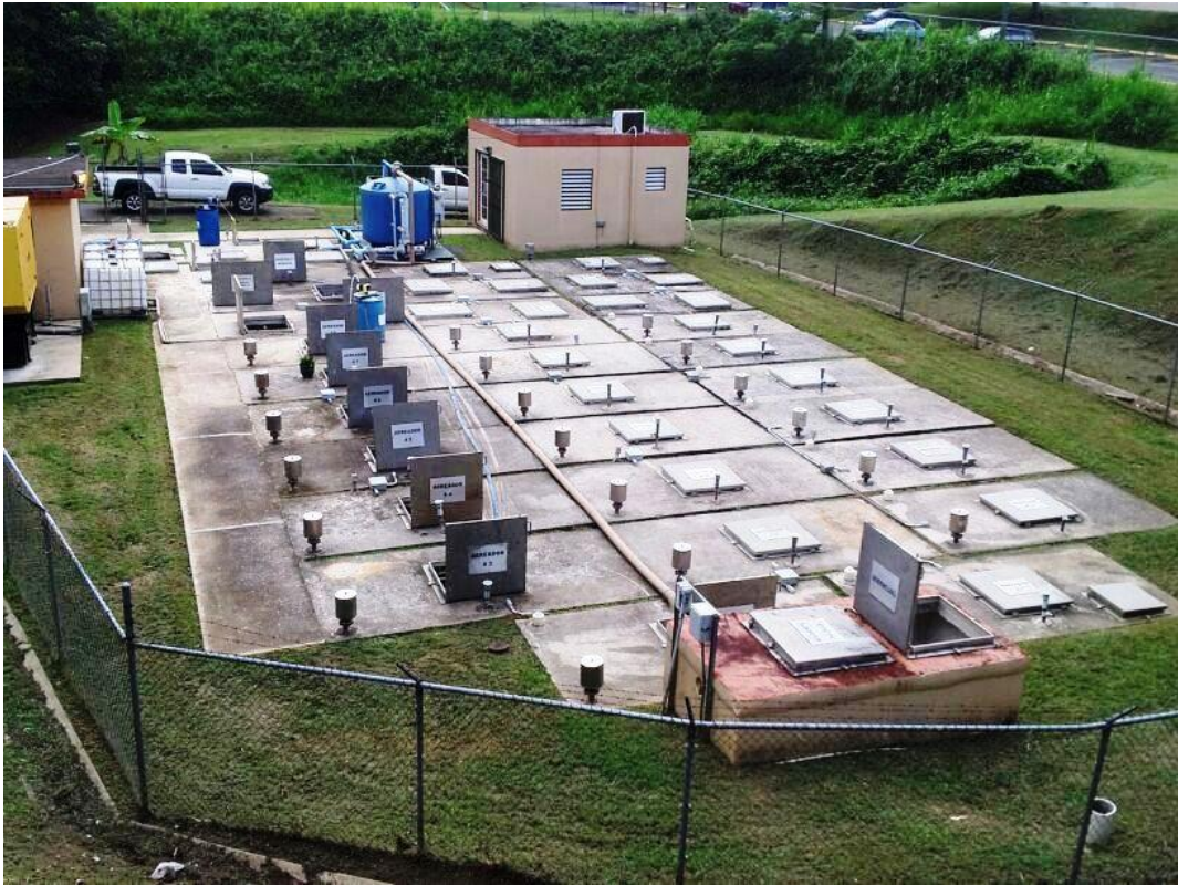
Planta de Tratamiento de Aguas Usadas
